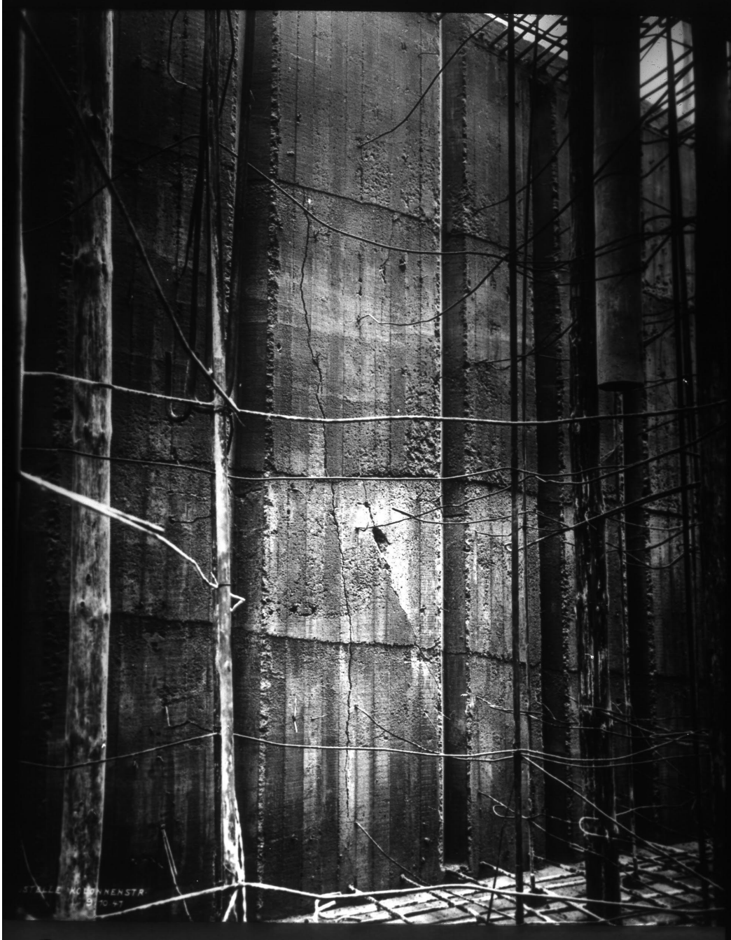
Fig. 13. Degebo. “Probebelastung auf Berliner Geschiebemergel in der Nähe der Kolonnenbrücke: Rißbildung beim sektorweisen Betonieren des Pilzkopfes.” 9 Oct 1941.
