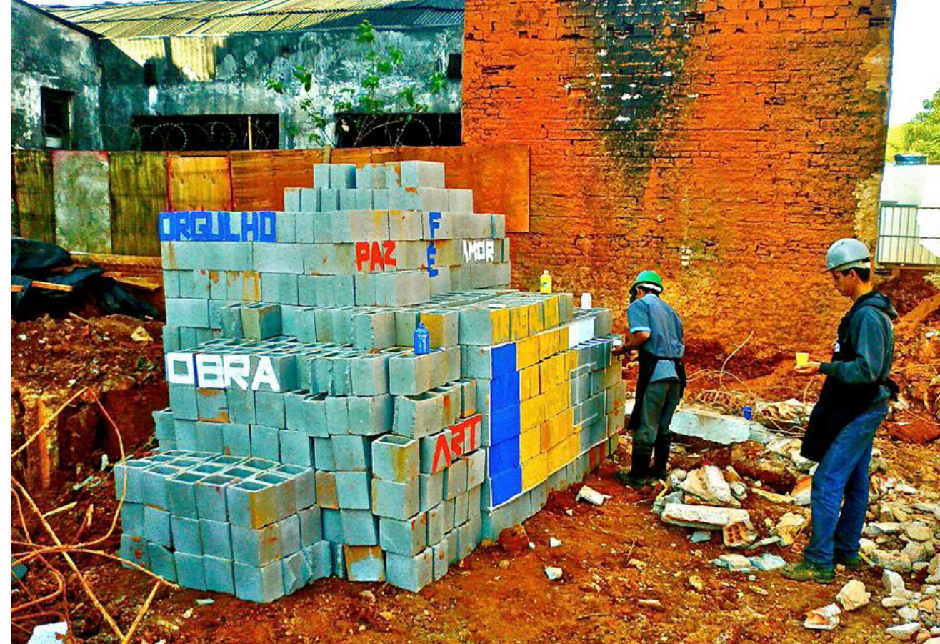
[Imagem 2] Participantes trabalham com bloco de concreto e tintas coloridas no Canteiro de Obras. Mestres da Obra, 2013
