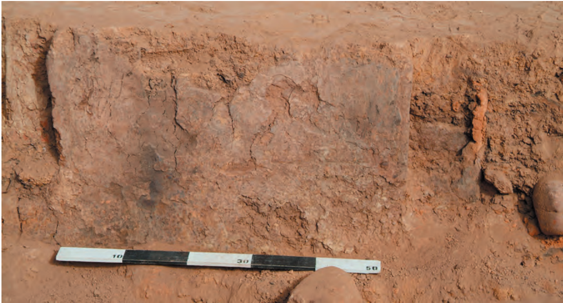
Figura 3.15 Detalle de la pared oeste de la Estructura 4 (Evento 542) mostrando el revoque.
