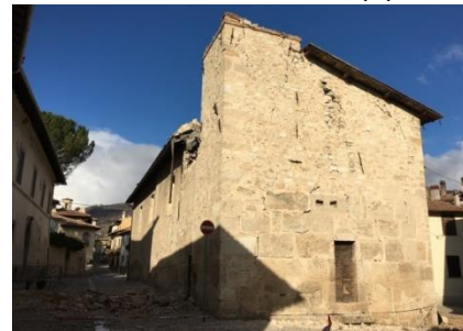
N. 21 Collapsed church (1)
