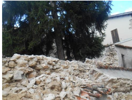
N. 8 Collapsed wall
