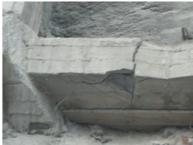
(d) Crack D on reinforced concrete lattice
